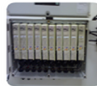
Sistema de medição de energia elétrica Portarias n.º 371/2007 e n.º 11/2009
