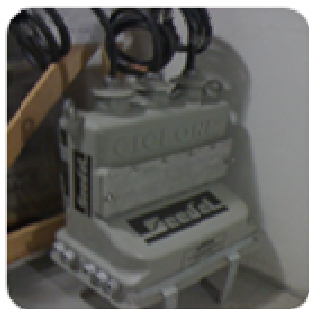
Sistema encapsulado de medição a transformador a seco Portaria n.º 159/2007
